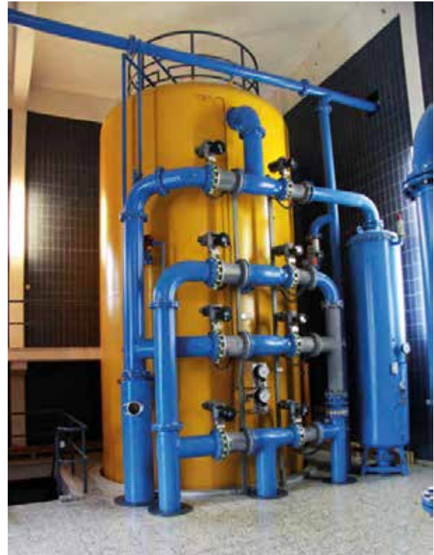
Geschlossener Doppelstagen-Filter zur Aufbereitung des Grundwassers (=Rohwasser)
