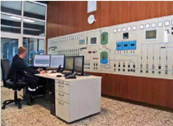
Digitaler Leitstand im Wasserwerk
