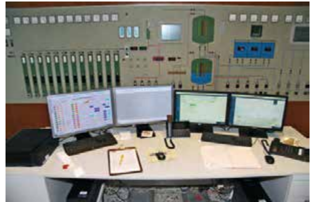
Arbeitsplatz der Wassermeister: Überwachung, Dokumentation, Steuerung.
