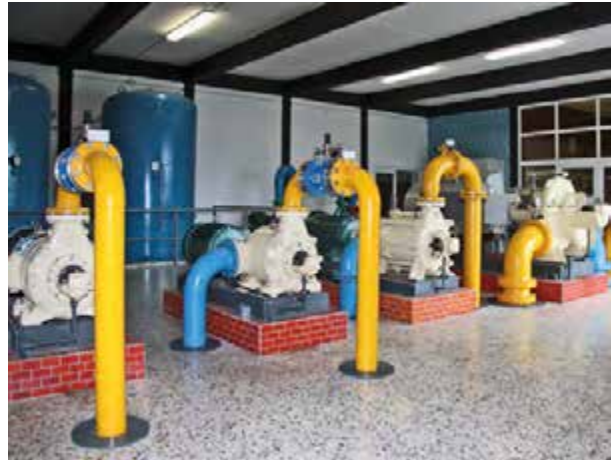
Pumpenhalle mit den Reinwasserpumpen
