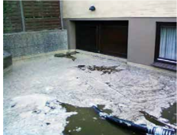
Rohrbruch in Jübek 2010
