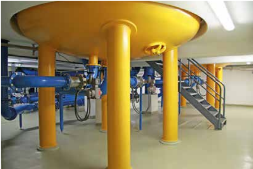
Nach Durchlaufen des Filters gelangt das Reinwasser (= Trinkwasser) über ein Rohrsystem in die Reinwasserbehälter
