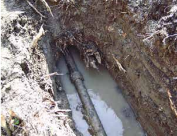
Rohrbruch durch eine Baumwurzel
