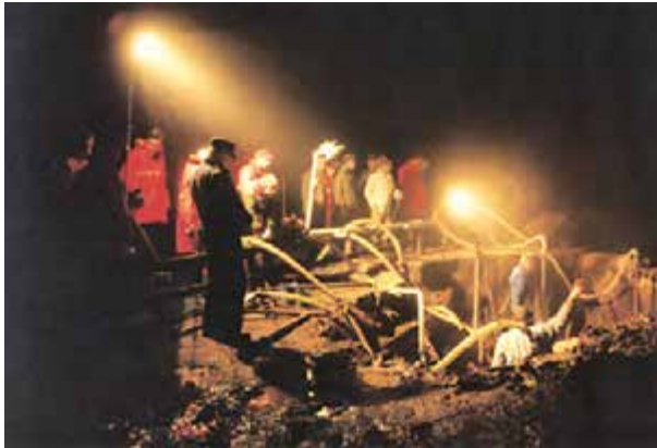
Rohrbruch einer Hauptversorgungsleitung am 29. 11. 1991 in Dörpstedt und Schadensbehebung bis 23 Uhr
